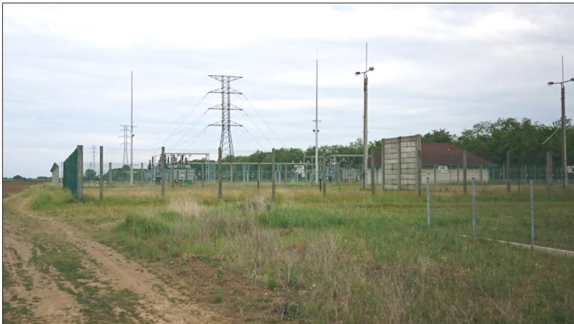
11. ábra: Transzformátor állomás a szomszédos területen
