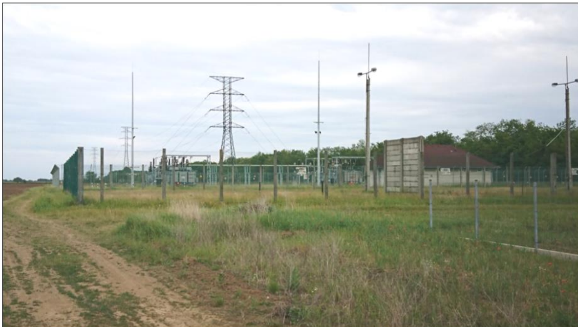
11. ábra: Transzformátor állomás a szomszédos területen
