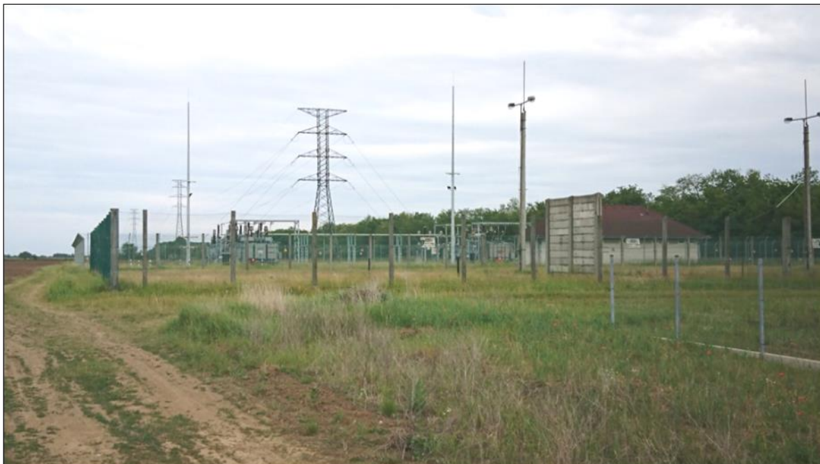
11. ábra: Transzformátor állomás a szomszédos területen
